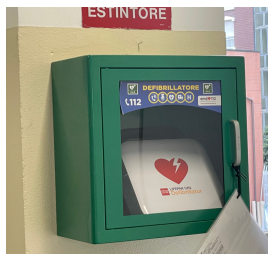
事務室前に設置しているAED
